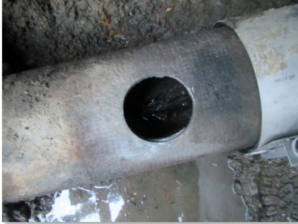
Photo C-9. Pipe coupon hole
